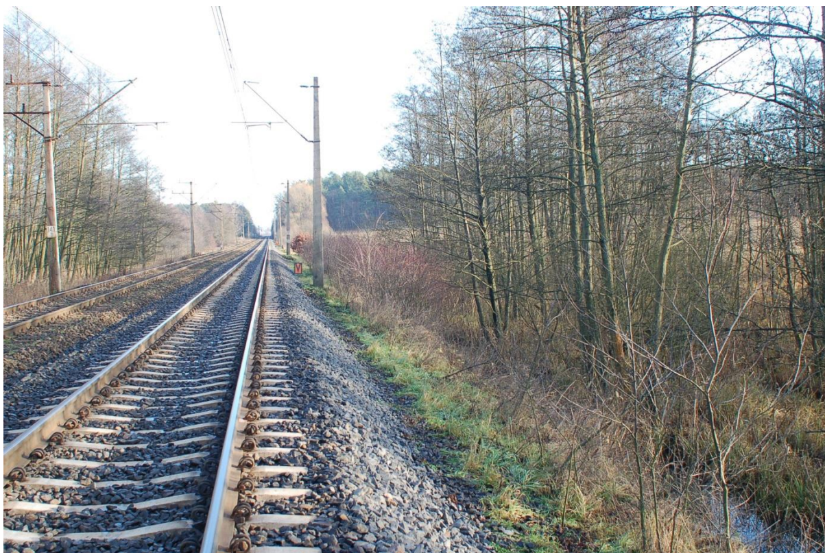
Fot. 21. Stagnowanie wody w obrębie postawy nasypu
