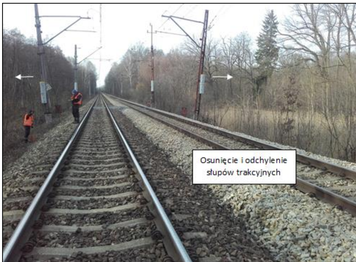
Fot. 25. Osunięcie i odchylenia słupów trakcyjnych
