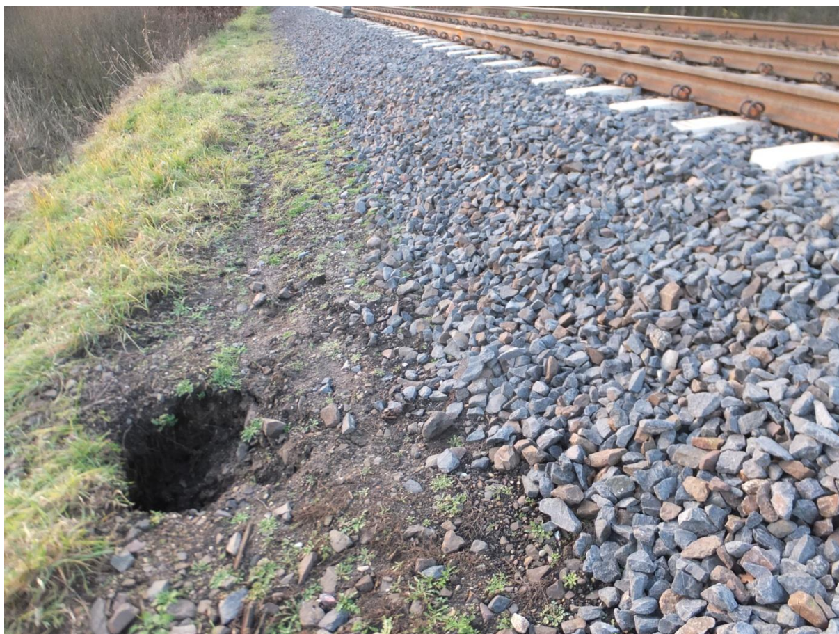
Fot. 20. Zapadlisko i odspojenia nasypu
