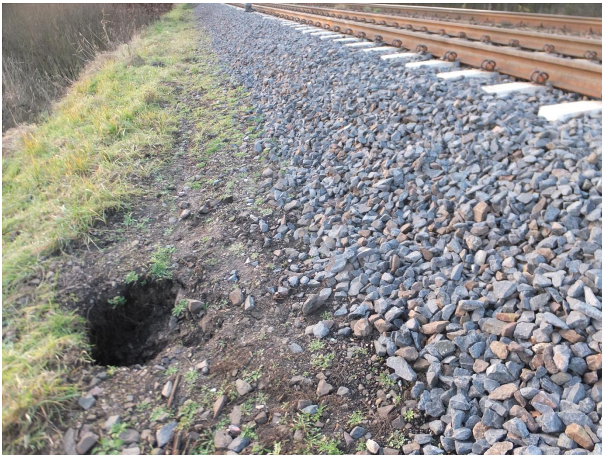
Fot. 20. Zapadlisko i odspojenia nasypu
