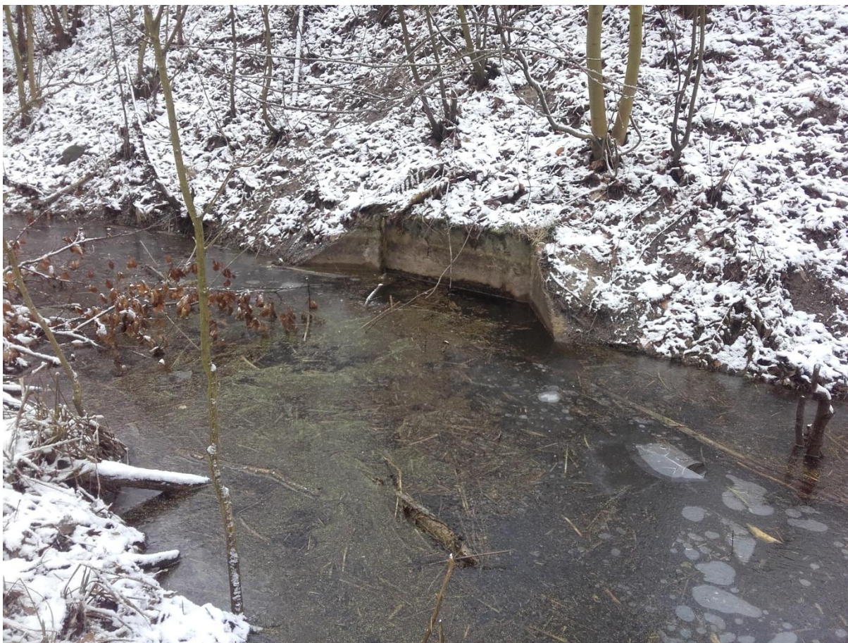
Fot. 2.9. LK nr 351, km 121,840 ÷ 121,950. Zablockowany przepust – katastrofalny napór wody powierzchniowej.
