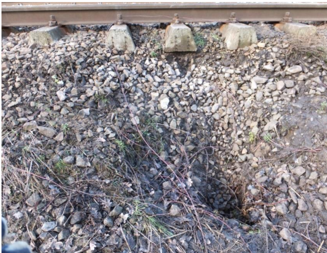
Fot. 11. Deformacja skarpy – powstanie leja sufozyjnego, odsłonięte czoła podkładów
