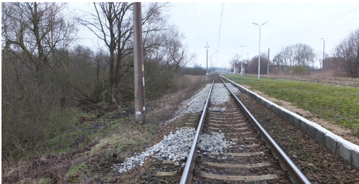
Fot. 2.3. LK nr 202, km 178,000 ÷ 178,100 Deformacja toru po zniszczeniu systemu drenażu – deformacja toków szynowych i tymczasowe zabezpieczenie stabilności nawierzchni kolejowej.
