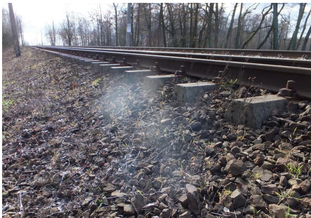
Fot. 10. Brak ławy torowiska i odsłonięte czola podkładów
