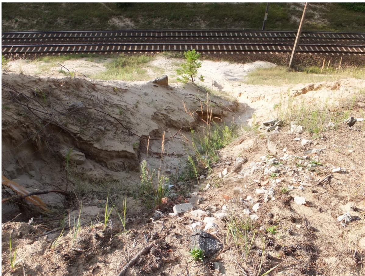
Fot. 2.2 LK nr 401, km 84,800 ÷ 85,050 - rozcięcie erozyjne w skarpie wraz z wyflukanym materiałem drobno-piaszczystym.
