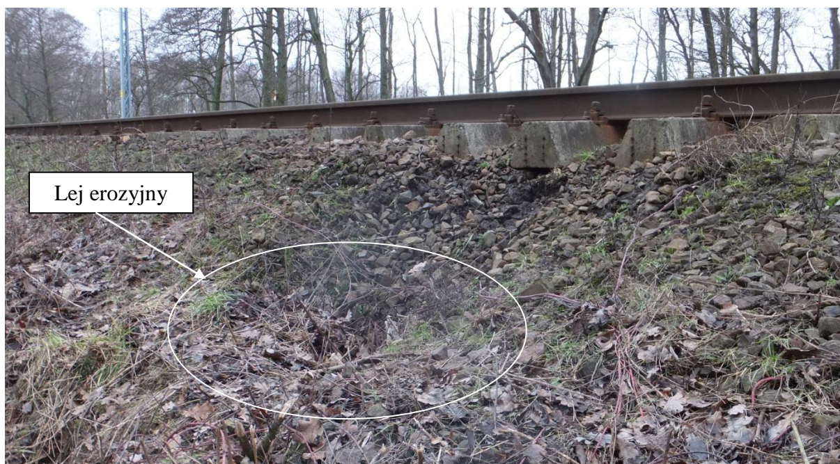
Fot. 2.4. LK nr 273, km 291,160 ÷ 291,190- deformacja skarpy - brak ławy torowiska oraz lej erozyjny, odsłonięte czoła podkładów
