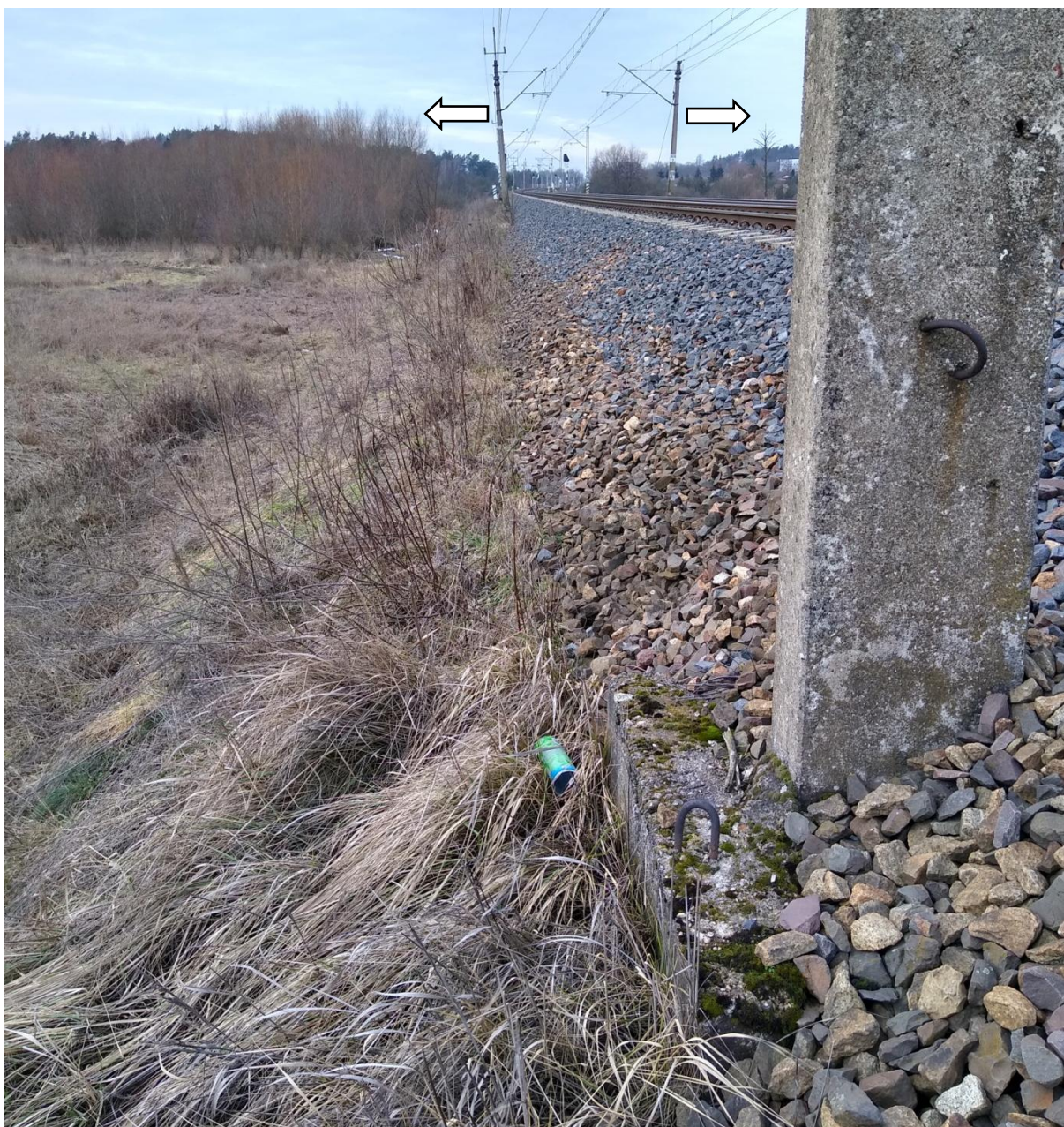
Fot. 2.10. LK nr 3, km 409,000 ÷ 409,940 Rozpełzywanie nasypu, brak ławy torowiska. Na dalszym planie widoczne odchylenia od pionu słupów trakcyjnych.
