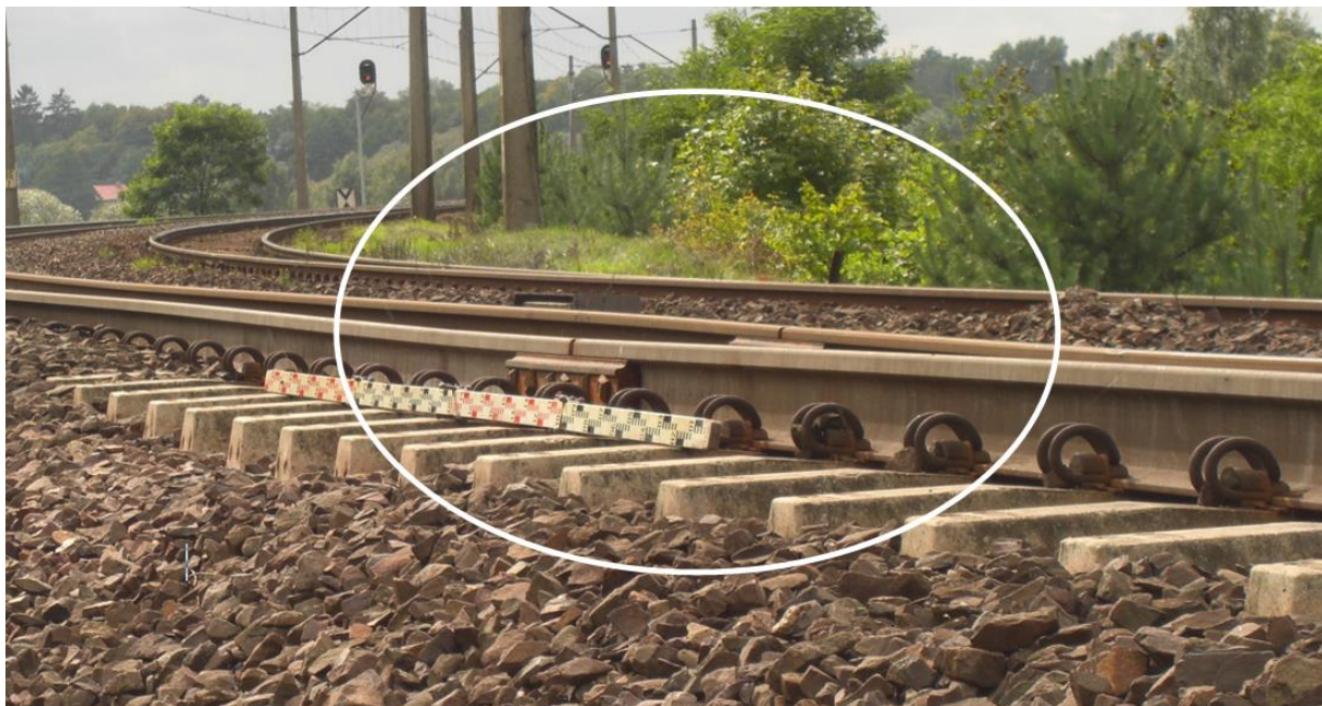
Fot. 2. Odkształcenia pionowe toków szynowych toru nr 2 oraz widoczny brak obsypki czoła podkładów
