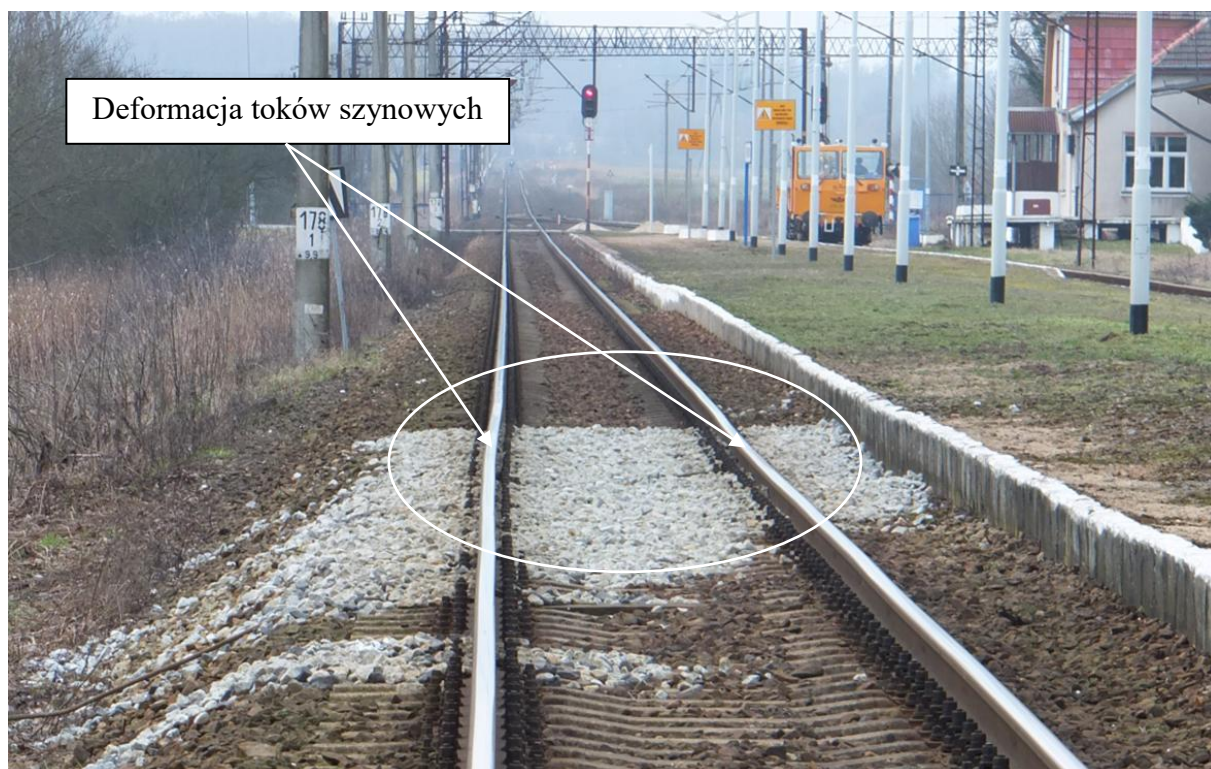
Fot. 1.1. Lokalna strefa utraty stabilności podtorza – LK 202 km 178,000 ÷ 178,100. Przykład deformacji toków szynowych po zniszczeniu systemu odwadniającego toru stacyjne.
