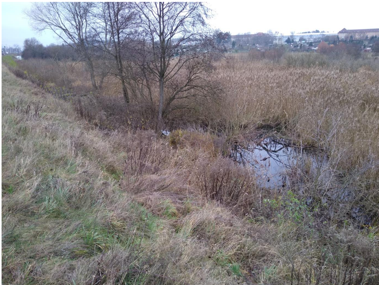
Fot. 28. Widok na dolinę rozlewiskową rzeki Pławnica od strony toru nr 1. Podtapianie podstawy nasypu.
