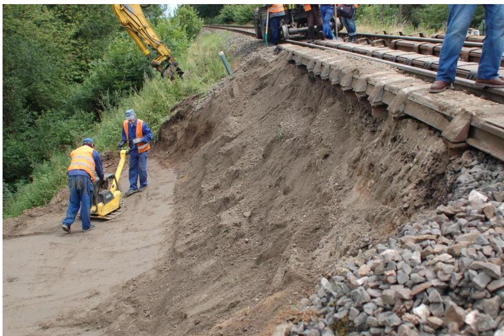
Fot. 15. Miejsce awarii – tymczasowe zabezpieczenie nasypu. Na zdjęciu widoczna założona konstrukcja ociążająca z wiązek szyn dla utrzymania stabilności toru i awaryjnej przejazdowości toru
