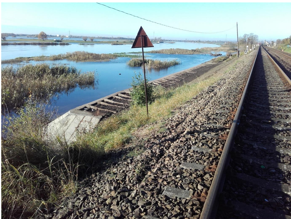
Fot. 19. Miejsce awarii po docelowej naprawie
