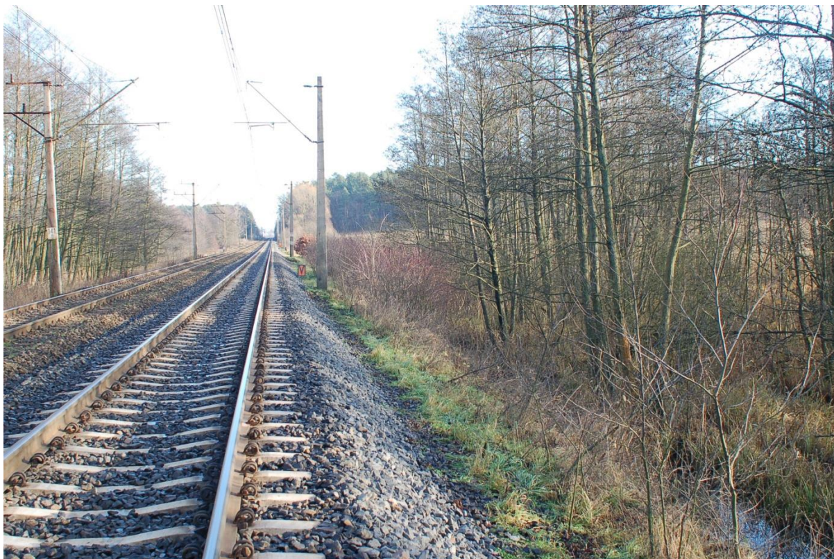
Fot. 21. Stagnowanie wody w obrębie postawy nasypu
