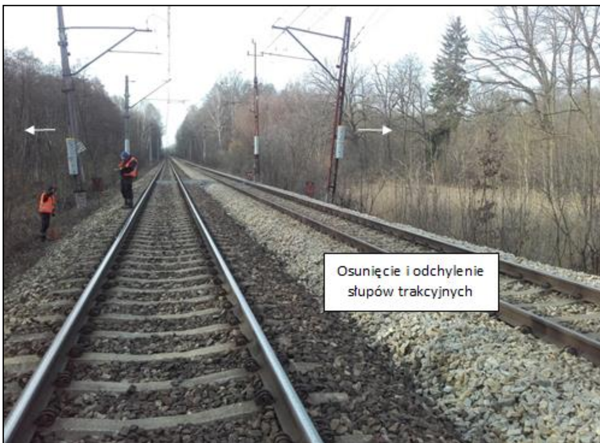
Fot. 25. Osunięcie i odchylenia słupów trakcyjnych
