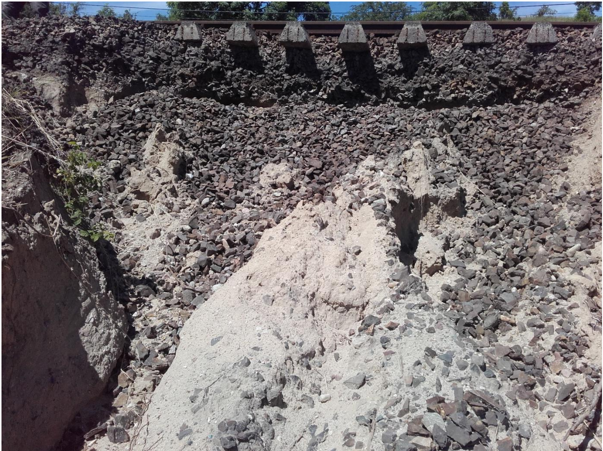
Fot. 18. Miejsce awarii – rozcięcie erozyjne wraz z lejem u podstawy skarpy. Widoczne podkłady kolejowe nie mające oparcia
