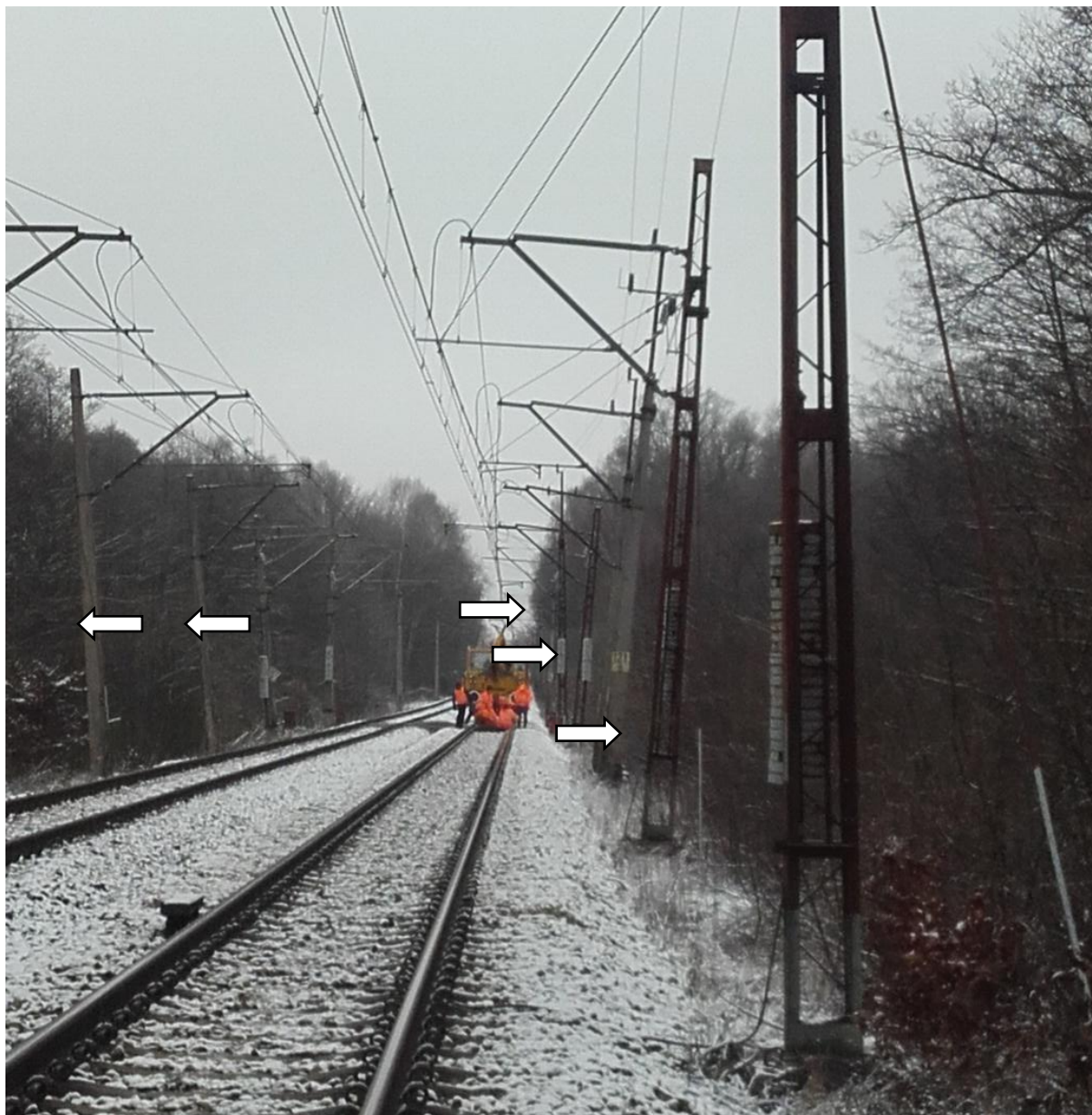
Fot. 2.8. LK nr 351, km 121,840 ÷ 121,950. Skutki nadmiernego odkształcenia podłoża gruntowego oraz intensywnych procesów sufozyjnych. Widoczne odchylenia od pionu słupów trakcyjnych.
