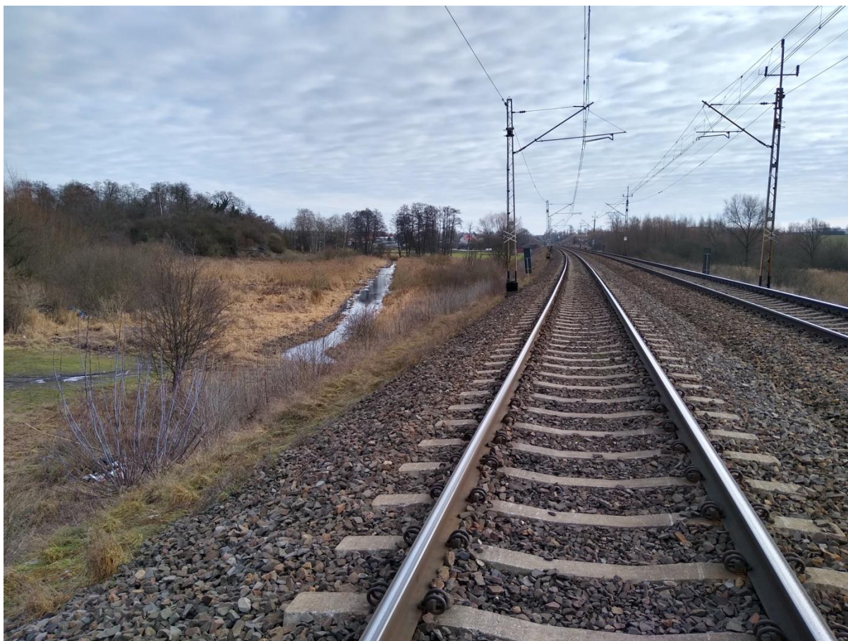
Fot. 27. Widok na dolinę rozlewiskową oraz rzekę Pławnica od strony toru nr 1. Widoczne wychylenia słupów trakcyjnych
