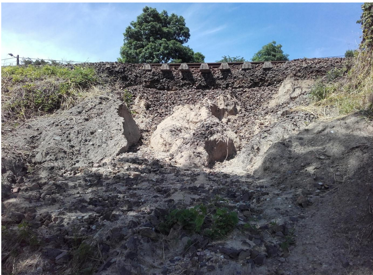
Fot. 2.6. LK nr 203, km 290,600 ÷ 290,720. Miejsce katastrofy – koluwium osuwiskowe z rozcięciem erozyjnym skarpy. „Wiszące” podkłady kolejowe.
