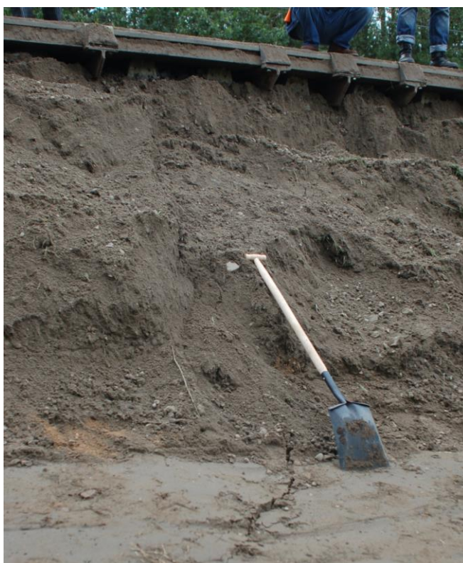
Fot. 16. Spękania widoczne na tymczasowym zabezpieczeniu nasypu, świadczą o pełzającym osuwisku
