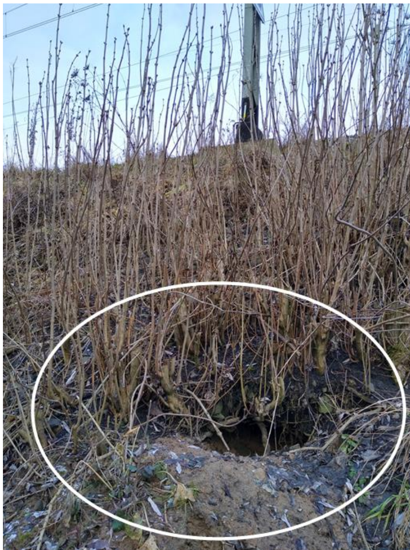
Fot. 29. Nory zwierzęce w skarpie nasypu od strony toru nr 2
