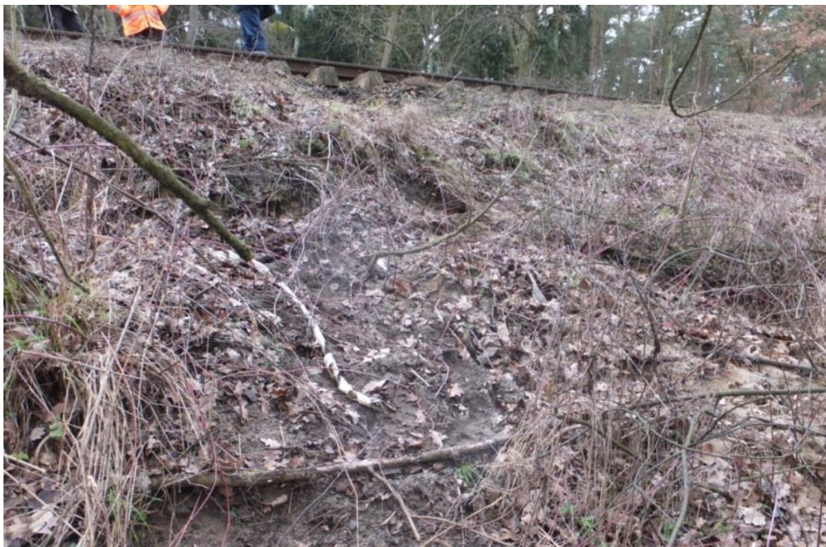
Fot. 9. Deformacja skarpy - brak ławy torowiska i odsłonięte czola podkładów
