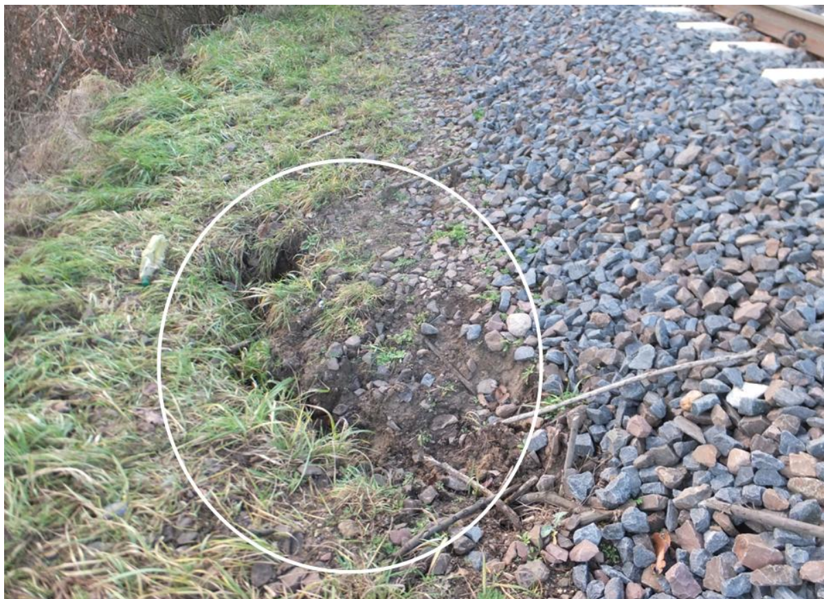
Fot. 2.7. LK nr 351, km 140,700 ÷ 141,200. Osiadanie podstawy skarpy - spękania i odspojenia w nasypie.
