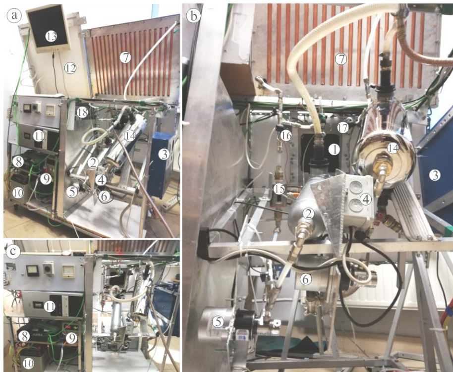
Rysunek 7.5 Widok z tyłu stanowiska badawczego hybrydowego systemu fotowoltaicznego: 1 – minikanałowy wymiennik ciepła PVT , 2 – rurowy wymiennik ciepła na obiegu zimnej wody, 3 – skrzynka metalowa z regulatorem solarnym PWM , 4 – regulatory obrotów pomp, 5 – pompa magnetyczna obiegu zimnego, 6 – pompa magnetyczna obiegu gorącego, 7 – minikanałowy wymiennik ciepła z panelem słonecznym, 8 – stacja akwizycji danych, 9 – zasilacz laboratoryjny DC, 10 – akumulator AGM 120Ah, 11 – komputer ze stacją akwizycji danych, 12 – duży panel solarny, 13 – monitor LCD, 14 – wymiennik rurowy do chłodzenia czynnika roboczego gorącego, 15 – przepływomierz magnetyczny na obiegu cieczy zimnej, 16 – przetwornik ciśnienia na wlocie do modułu testowego (obieg zimny), 17 – przetwornik ciśnienia na wylocie z modułu testowego (obieg gorący), 18 – miernik laboratoryjny
