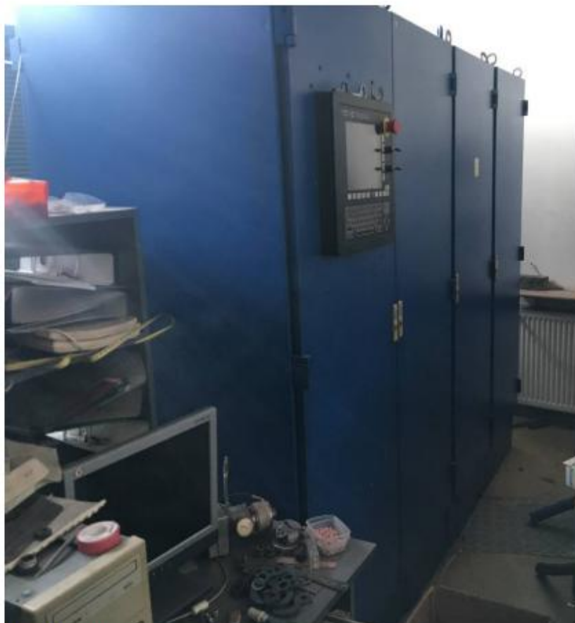
Rys. 7. Widok szafy sterowniczej
