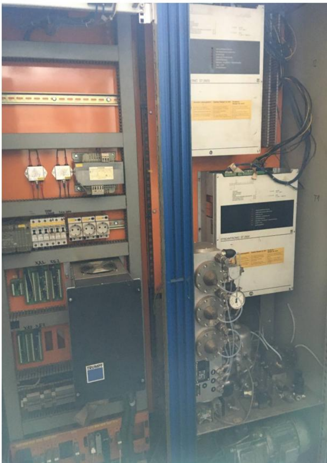
Rys. 9. Widok wnętrza szafy.
