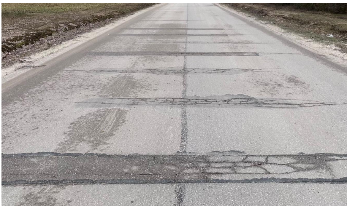
Rys. 3.5. Spękanie odbite, zainicjowane w warstwie podbudowy drogowej – powiat tomaszowski, województwo łódzkie
