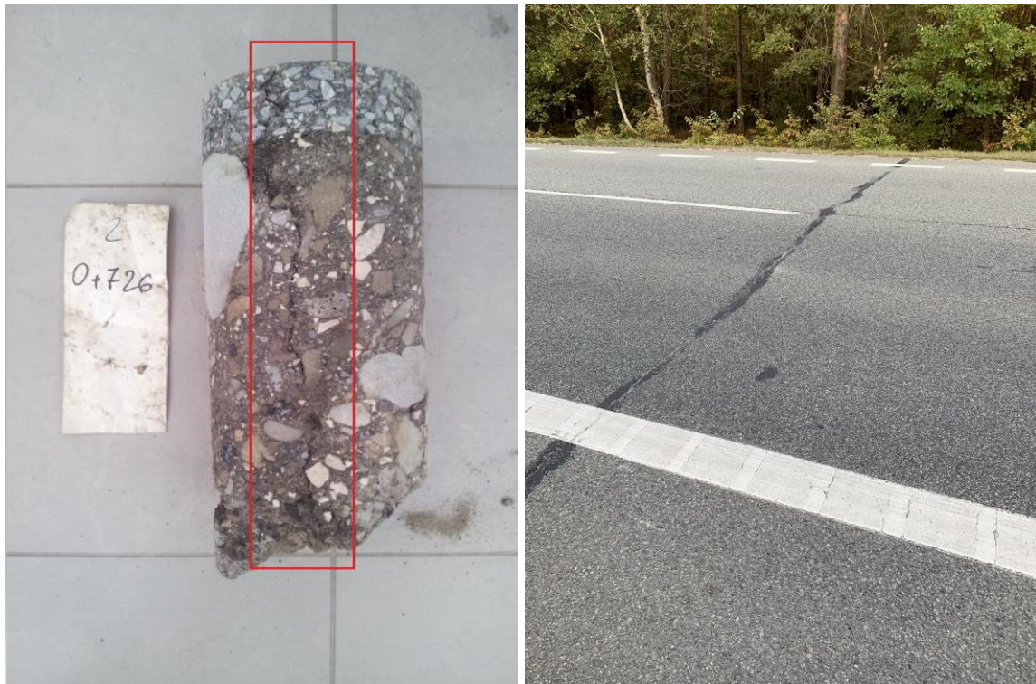
Rys. 3.6. Spękania odbite w podbudowie z mieszanki MCE
