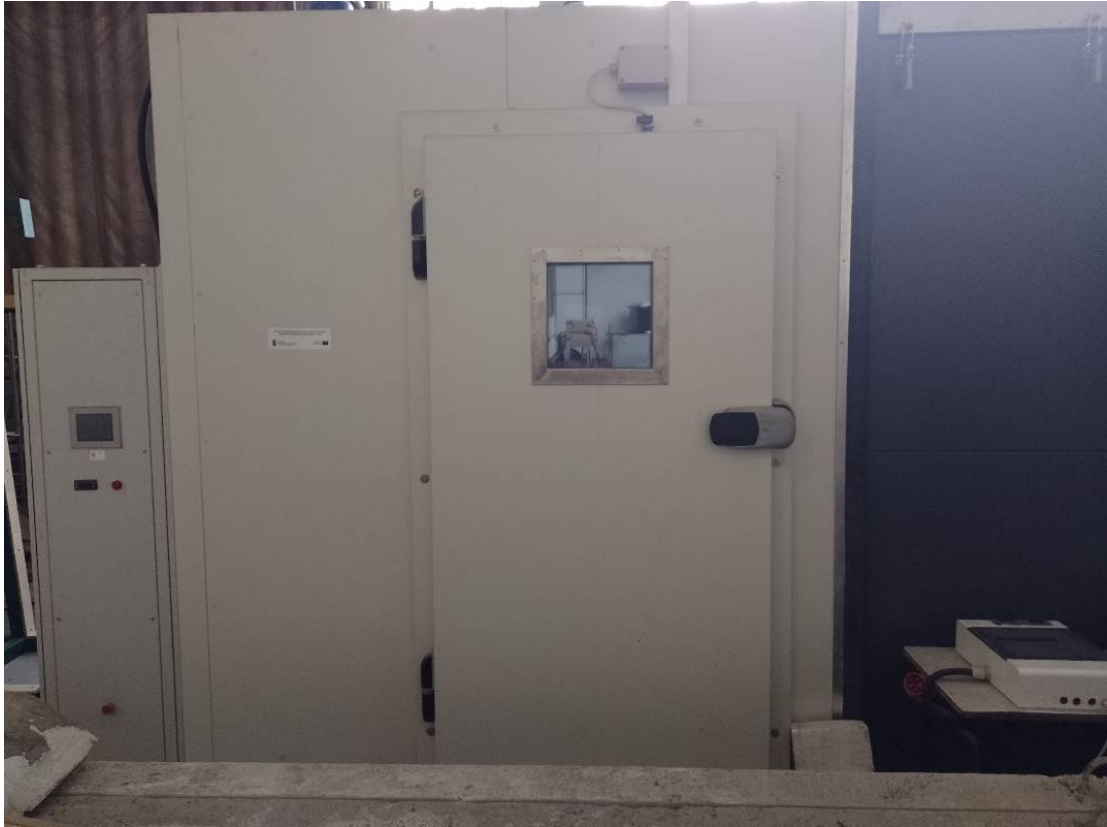
Rys. 29. Komora klimatyczna – część lewa symuluje warunki środowiska wewnętrznego.
