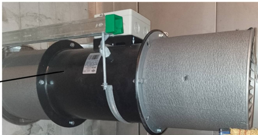
Rys. 32. Urządzenie do wentylacji fasadowej (widok od strony symulującej warunki środowiska zewnętrznego).
